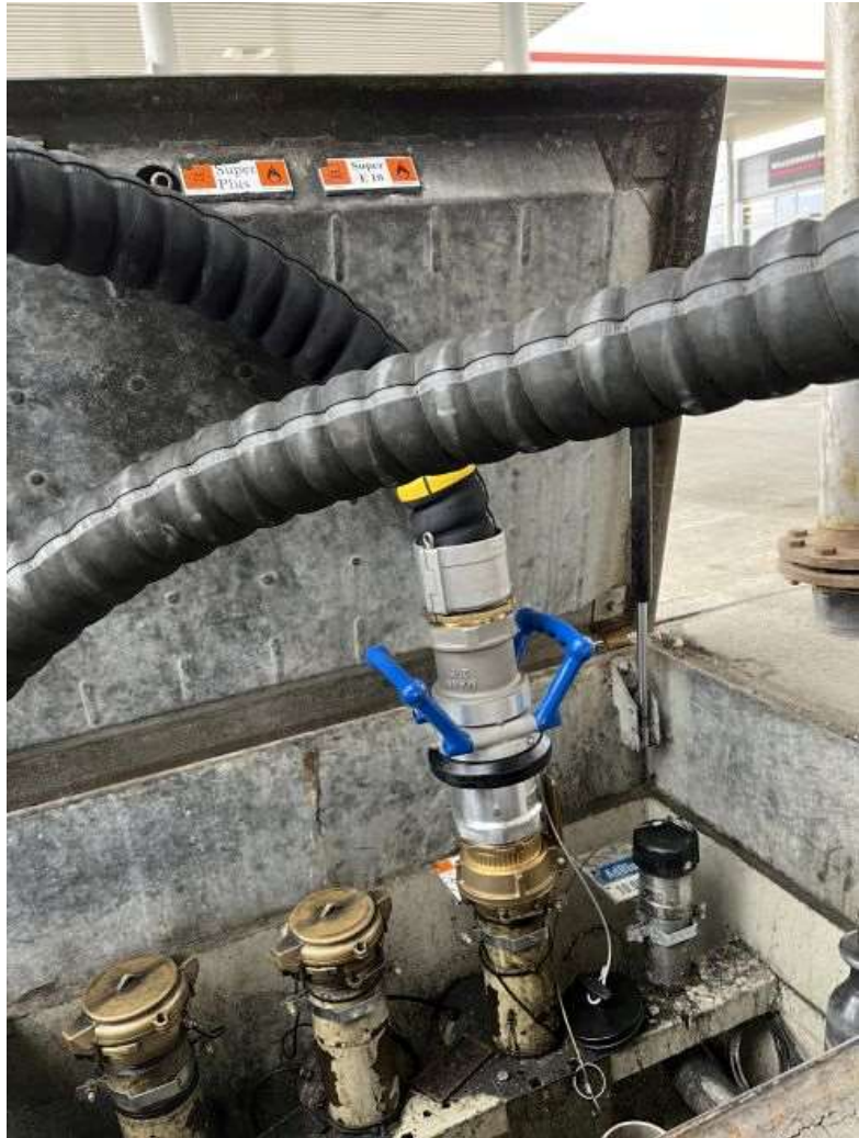
Anschluss der Trockenkupplung am Lagertank
